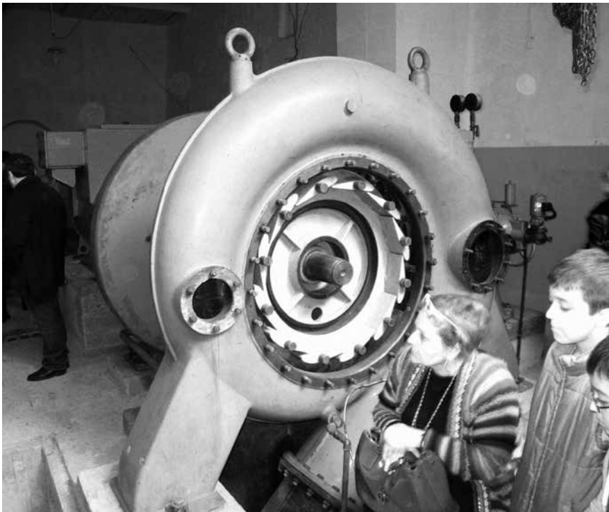
Το εσωτερικό του εργοστασίου και η τουρμπίνα ηλεκτροπαραγωγής.
